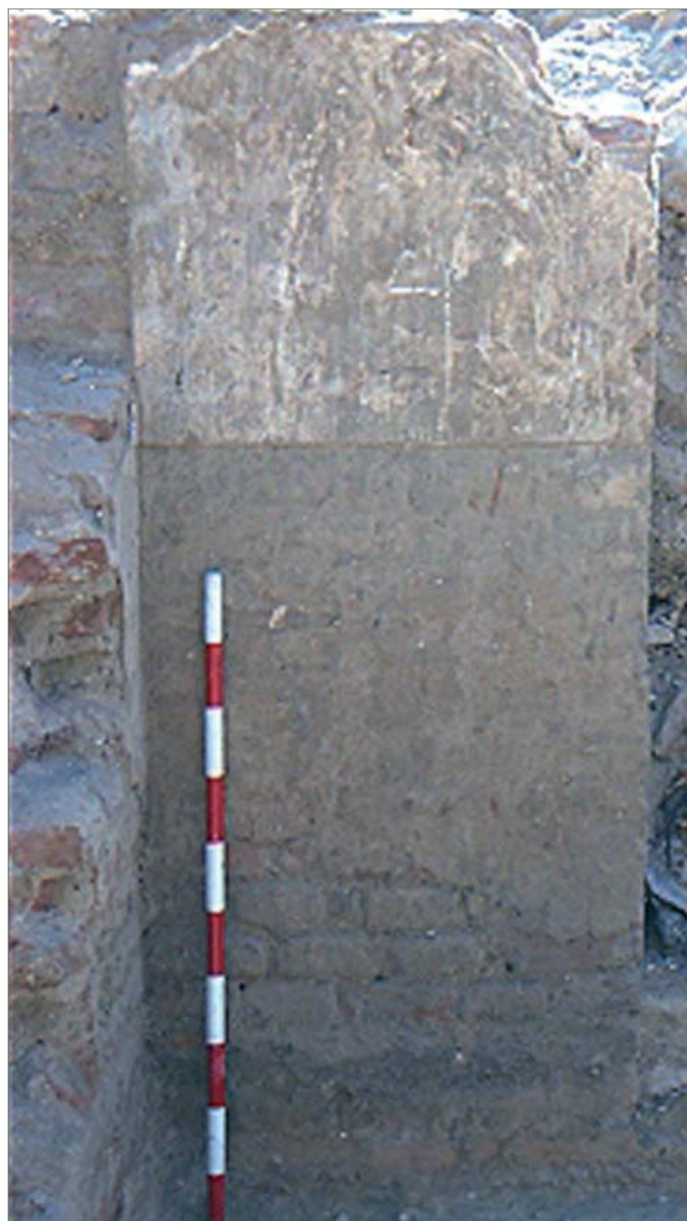
Figura 2 - Detalle de los yesos de las paredes del sótano
